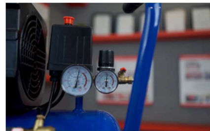
Gambar 9. Tekanan Kompresor Sumber : PT. Orientama Lintas Buana (2024)
